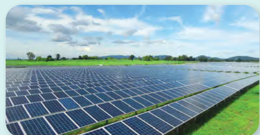
รูปที่ 3.3 Source: แสดงลักษณะ Solar farm
